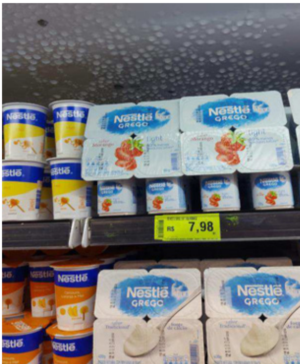
Figura 2. Condensação no expositor vertical refrigerado aberto.
