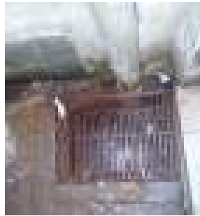
Figura 1. Caixa de esgoto em péssimo estado de conservação.
